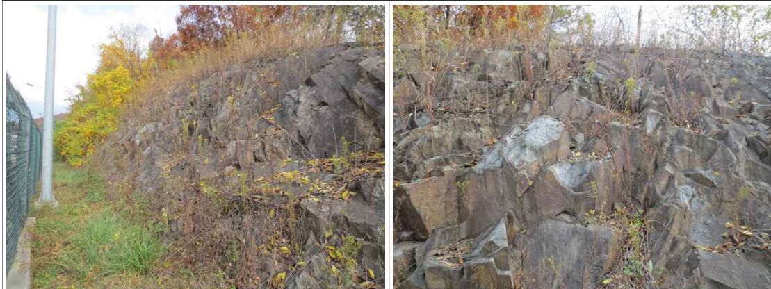
1 (2공구) 기타종사면92 (87.11~87.23K) 1단 이완암 및 뜯돌 ⇨ 주의관찰
