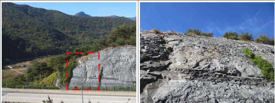
1 (6공구) 기타종사면40 (56.12K) 1단 이완암 ⇨ 주의관찰
