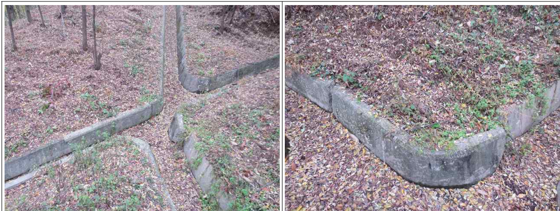
3 (2공구) 기타종사면89 (84.10K) 상단부 측구 파손 ⇨ 단면보수채
