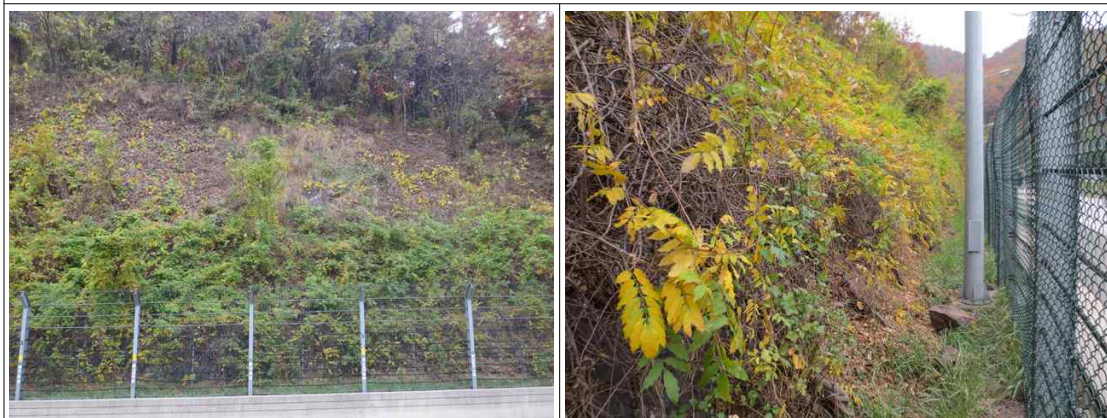
3 (3공구) 기타종사면74 (79.54K) 1단 이완암 및 낙석퇴적 ⇨ 주의관찰, 정비
