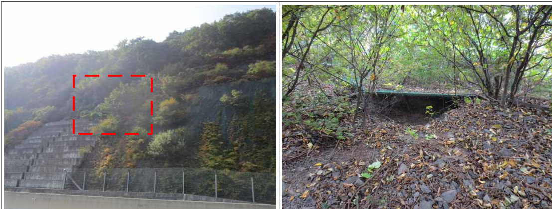
1 (10공구) 기타종사면19 (21.14K) 옹벽 상면 표층유실 ⇨ 숏크리트(A=10m*10m)
