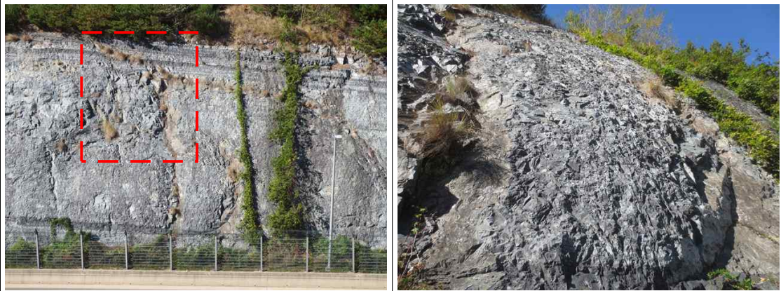
2 (6공구) 기타종사면40 (56.15K) 1단 이완암 ⇨ 주의관찰
