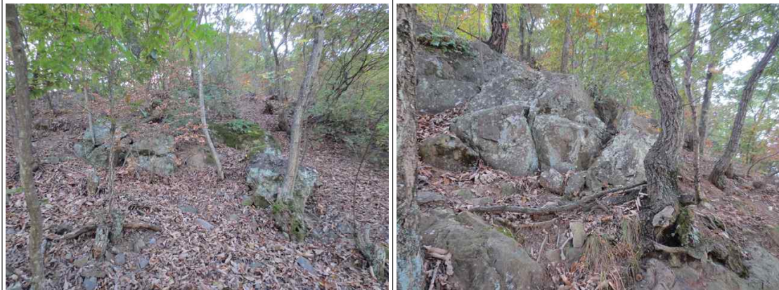
2 (10공구) 기타종사면21 (21.47~21.54K) 자연사면부 암괴 다수 분포 ⇨ 주의관찰
