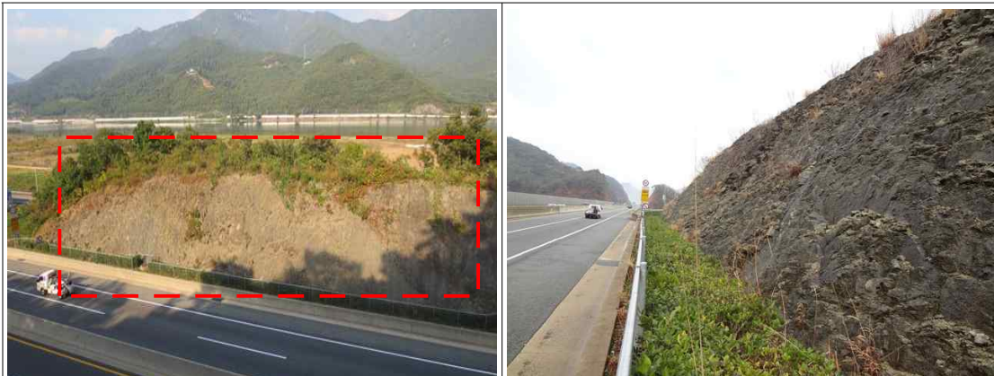
1 (10공구) 기타종사면14 (19.45~19.52K) 1단 심한풍화 및 이완암 ⇨ 주의관찰
