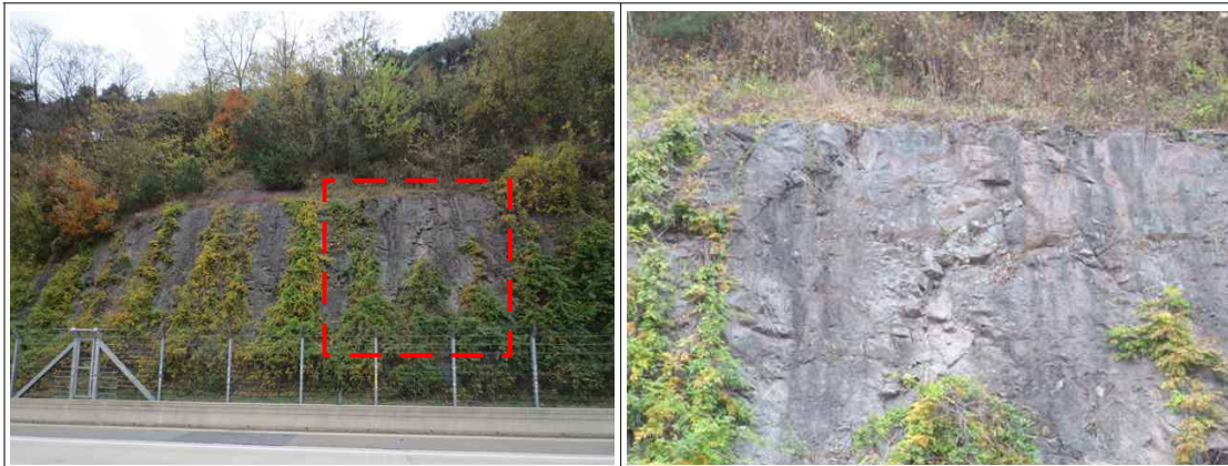
1 (3공구) 기타종사면74 (79.60K) 1단 이완암 ⇨ 주의관찰
