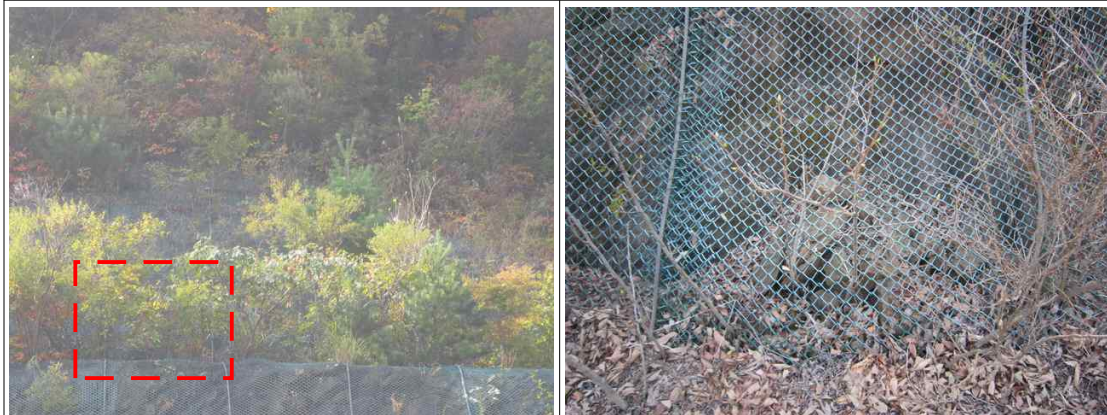
2 (10공구) 기타종사면19 (21.16K) 2단 낙석 망내 퇴적, 수목 ⇨ 정비, 벌목
