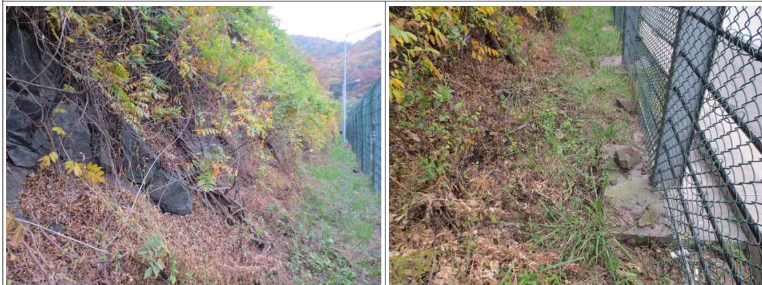
2 (3공구) 기타종사면74 (79.57K) 1단 이완암 및 낙석퇴적 ⇨ 주의관찰, 정비
