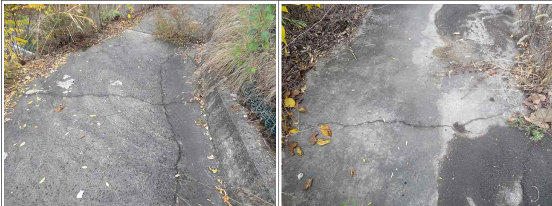
2 (2공구) 기타종사면95 (STA+25) 1소단 배수로 균열 ⇨ 균열보수
