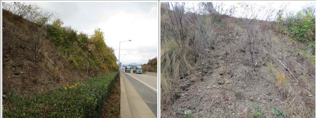
1 (1공구) 기타종사면98( 87.75~87.77K) 1단 심한풍화 ⇨ 방호벽(L=20m)
