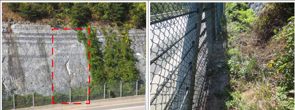
3 (6공구) 기타종사면40 (56.19K) 1단 이완암 ⇨ 주의관찰
