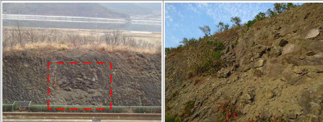
2 (10공구) 기타종사면14 (19.48K) 1단 심한풍화 및 이완암 ⇨ 주의관찰
