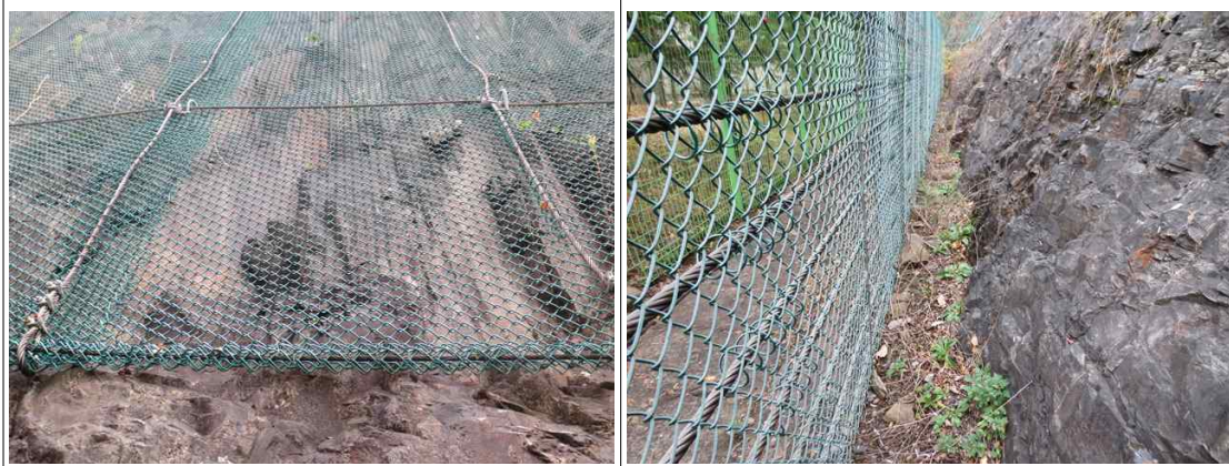
1 (2공구) 기타종사면95 (STA+20~35) 1단 이완암, 하부 낙석퇴적 ⇨ 주의관찰
