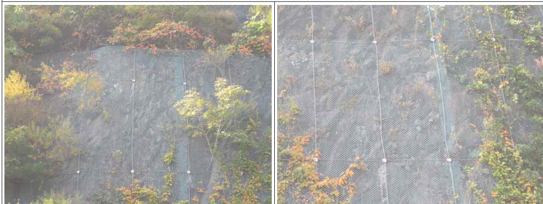
3 (10공구) 기타종사면19 (21.16K) 1단 이완암 ⇨ 주의관찰
